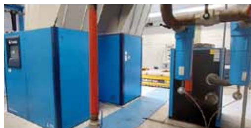
La sala compressori.
