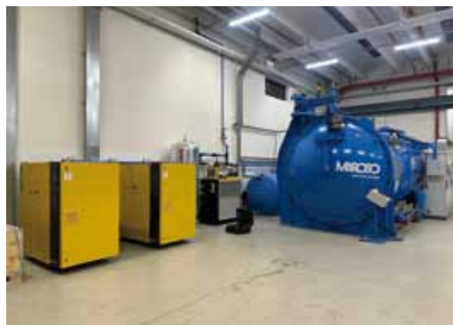
I compressori Kaeser da 45 kW.
