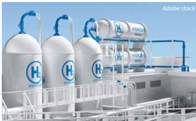
Immagazzinare l'idrogeno verde: la produzione e l'impiego di idrogeno verde richiedono infrastrutture apposite, dagli impianti di elettrolisi dell'acqua alle stazioni di rifornimento o di compressione di idrogeno.
