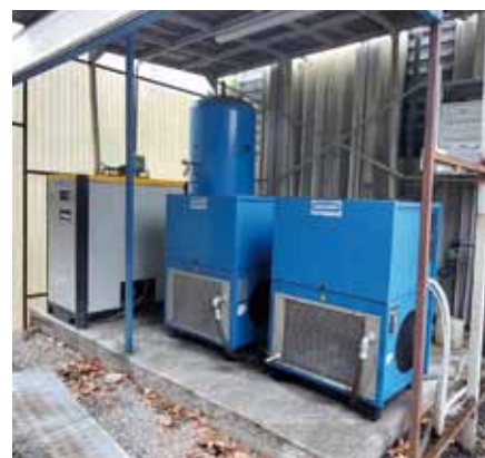
La sala compressori.
