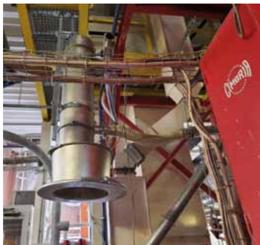
Uno dei due conveyor piFLOW ® f installati al quarto piano di Bayer Hungaria Kft.
