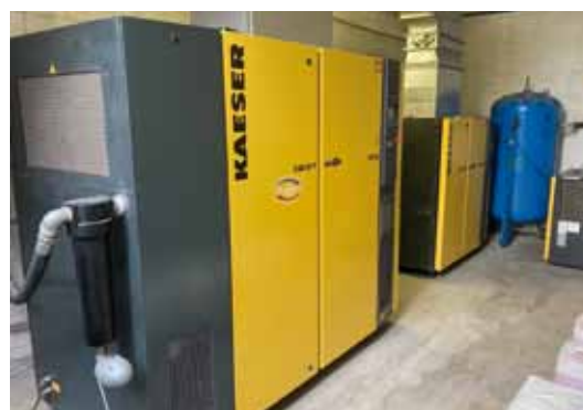
La sala compressori.
