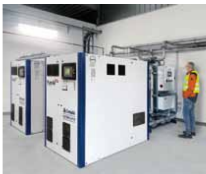
La sala di compressione e trattamento.
