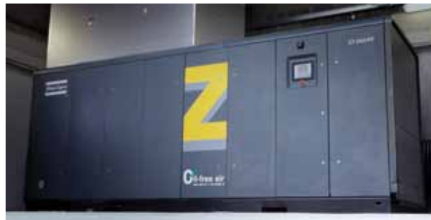
Il compressore oil-free ZT installato presso la Goglio.
