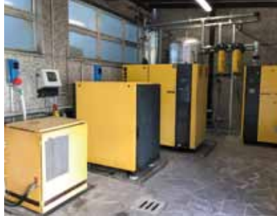
L'attuale sala compressori di Pianoro.
