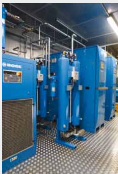
Container con compressori Boge.
