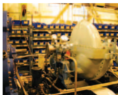
Fig. 1 - Compressore centrifugo azionato a turbina a vapore.
