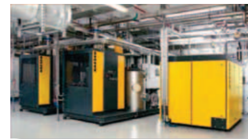
La sala compressori.
