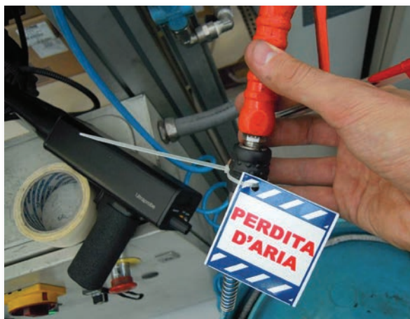
Fig. 1 - Perdita dal giunto sul fondo del manico della pistola ad aria compressa.
