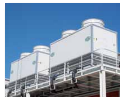
Torri a circuito aperto Pme- Pmee.
